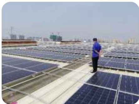
光伏发电系统
